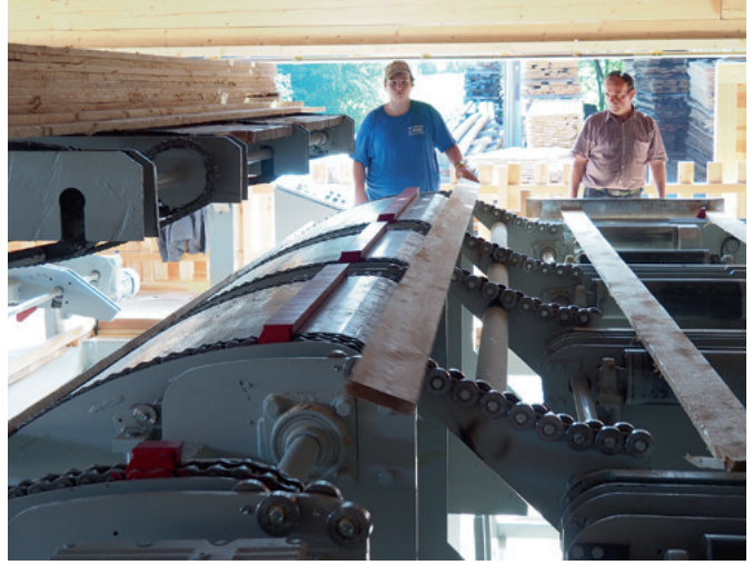
Transport in Richtung Paketieranlage: Auflöser mit Beurteilungsstation und nachfolgender Mess- und Stapelanlage
